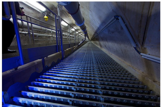
Schrägkläreranlage (Lamellenabscheider) am Fennsee (Foto: BWB)
