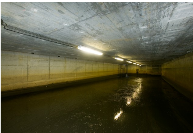
Regenklärbecken Schlierseeestrasse, Berlin-Köpenick (Foto: BWB)
